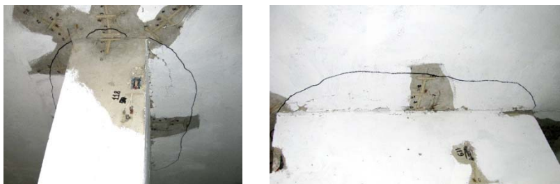
Рис. 3. Трещины на сжатой грани бетона образца КСП-4 после испытания
