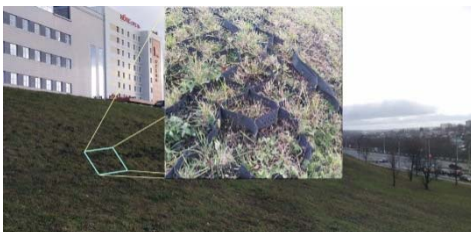
Рис. 1. Разрушение системы синтетических укреплений откоса
