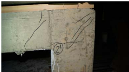
Рис. 6. Характер трещин на опорах при нагрузке 10 кН/м 2
