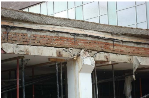
Рис. 4. Плита покрытия стилобата после разрушения
