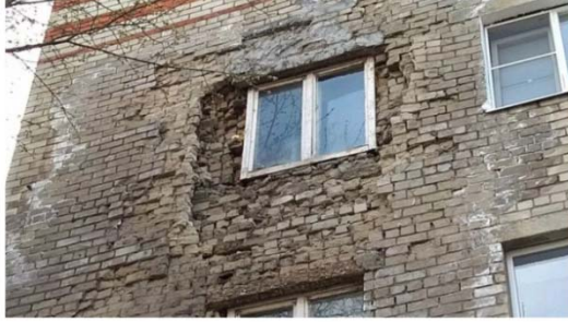
Рис. 4. Раздробление в зоне оконных проемов и перемычек, г. Ядрин, ул. 50 лет Октября, 98
