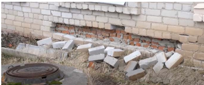
Рис. 6. Разрушение каменной кладки стен в их цокольной части, г. Ядрин, ул. 50 лет Октября, 98
