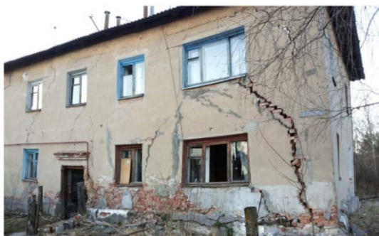
Рис. 3. Отслоение декоративной облицовки
