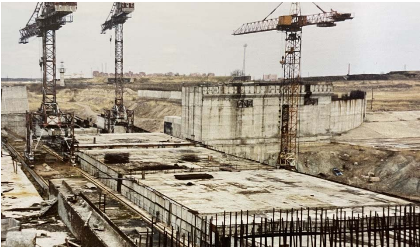
Брошенная стройка. Тоннель судопропускного сооружения С-1
