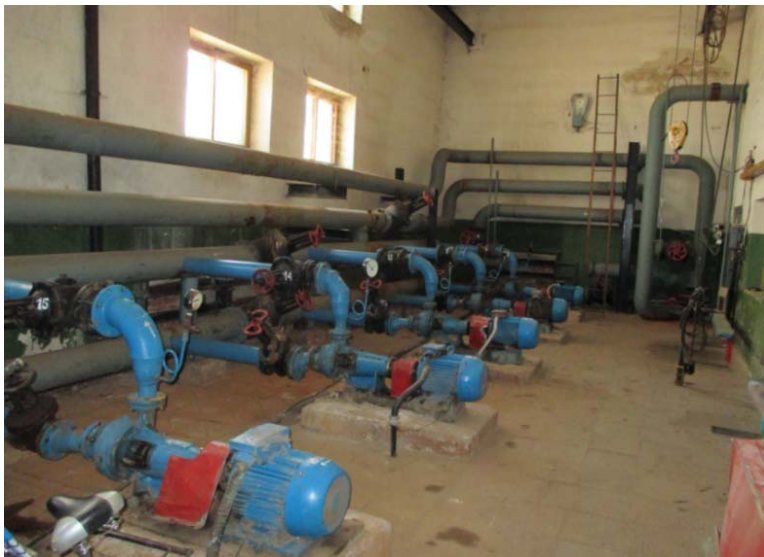
Рисунок 1 – Машинный зал ЦТП №1 до реконструкции насосного оборудования
