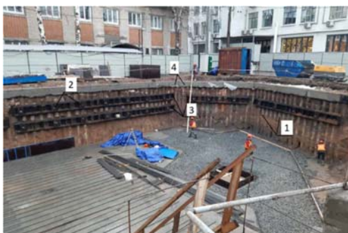
Рис. 6б. Фрагмент плана ограждения котлована: 1 – буроинъекционные сваи ЭРТ; 2 – грунтовые анкера ЭРТ; 3 – анкерный обвязочный пояс; 4 – монолитный железобетонный обвязочный пояс
