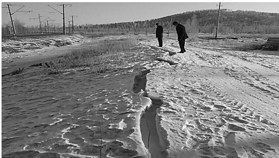
Рис. 1. Формирование бугра наледи вдоль железнодорожной насыпи на перегоне Тургутуй-Сохондо (высота 3,65 м, февраль 2014 г.)
