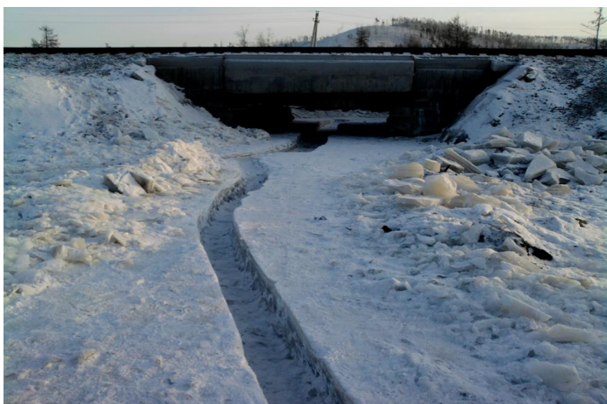
Рис. 2. Рост наледи под железнодорожным мостом (декабрь, 2013 г.)
