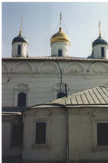
Рис. 1. Трещина над оконным проемом храма (северный фасад)
