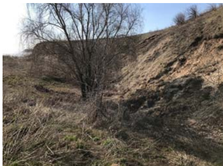
Рис. 2. Южнее Гурьева оврага склон, сложенный терригенными породами, срезан абразией. Оползень скольжения с головными блоками вращения и сброса (с деревьями)
