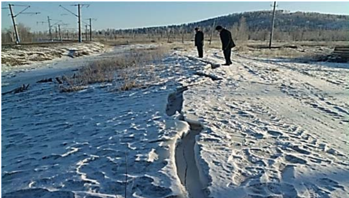
Рис. 2. Бугор наледи у моста и вдоль насыпи дороги (высота 2,5 м, март 2014 г.)
