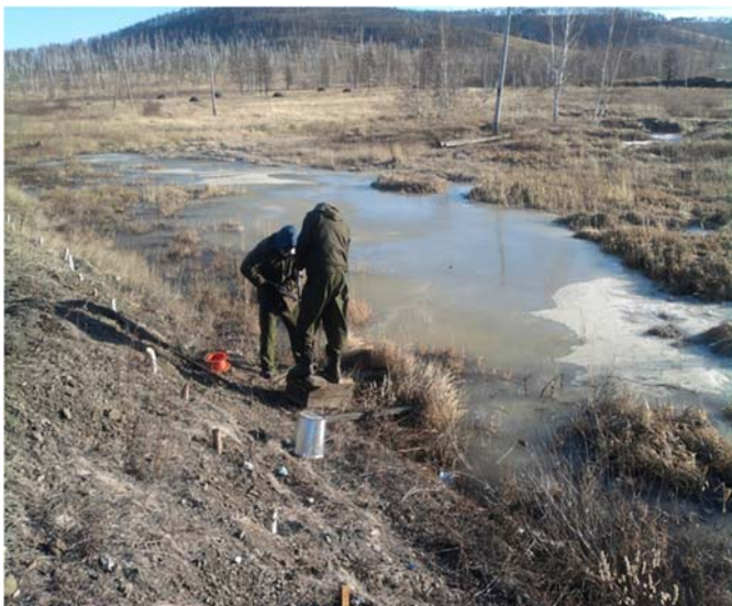
Рис. 6. Бурение скважин вдоль насыпи группой студентов для закачки раствора полимерного материала «Криогелит» при строительстве противодиффузионного экрана
