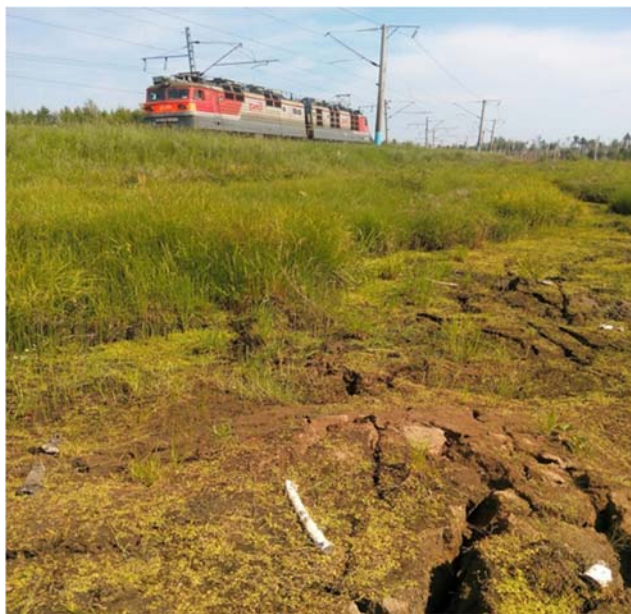
Рис. 15. Осушенный участок вдоль железнодорожной насыпи
