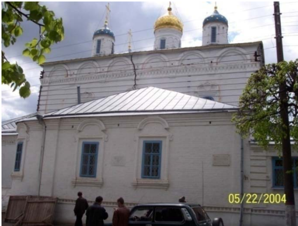
Рис. 2.1. Трещина над оконным проемом Введенского собора (видна в верхней части снимка посередине). Вид со стороны северного фасада.
