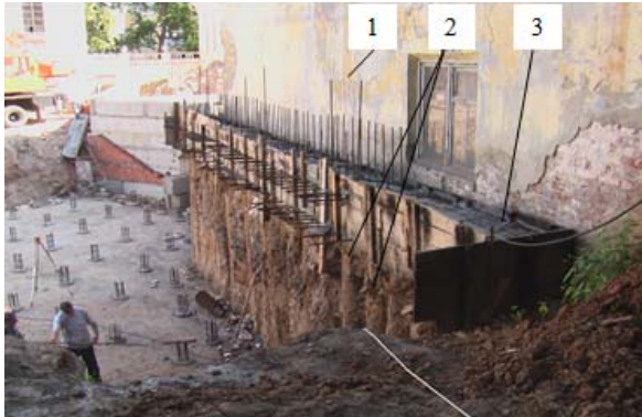
Рис. 3. Подпорная стена из двух рядов буринъекционных свай ЭРТ (РИТ, ФОРСТ, ЭРСТ) как ограждение котлована в г. Н. Новгород: 1 – усиливаемый объект; 2 – ограждение котлована из двух рядов буринъекционных свай ЭРТ (РИТ, ФОРСТ, ЭРСТ); 3 – монолитный железобетонный обвязочный пояс
