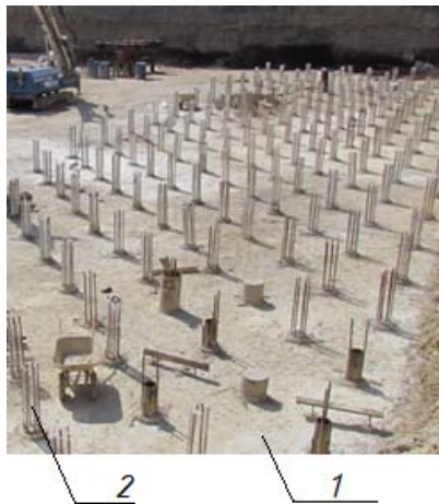
Рис. 3. Свайное поле из буроинъекционных свай ЭРТ (РИТ, ЭРСТ, ФОРСТ): 1 – бетонная подготовка; 2 – выпуски армокаркаса свай ЭРТ
