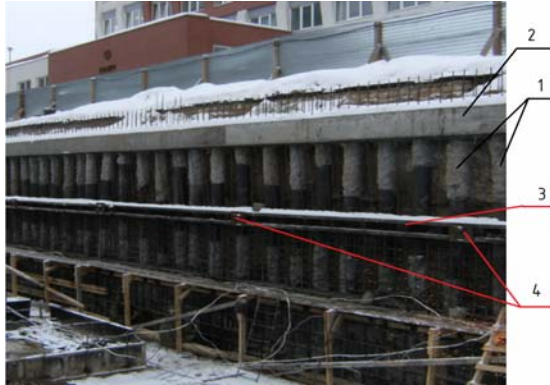
Рис. 10. Схема устройства ограждения котлована: 1 – буронабъекционные сваи ЭРТ (РИТ, ЭРСТ, ФОРСТ); 2 – монолитный ж/б обвязочный пояс; 3 – анкерный пояс; 4 – грунтовые анкера ЭРТ
