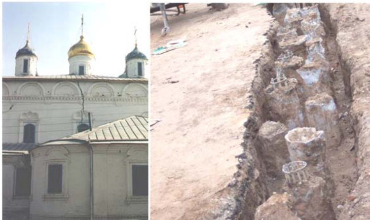
Рис. 5. Устройство стенки на основе буроинъекционных свай стабилизировало разрушение стены Кафедрального Собора (1651 г., в г. Чебоксары)
